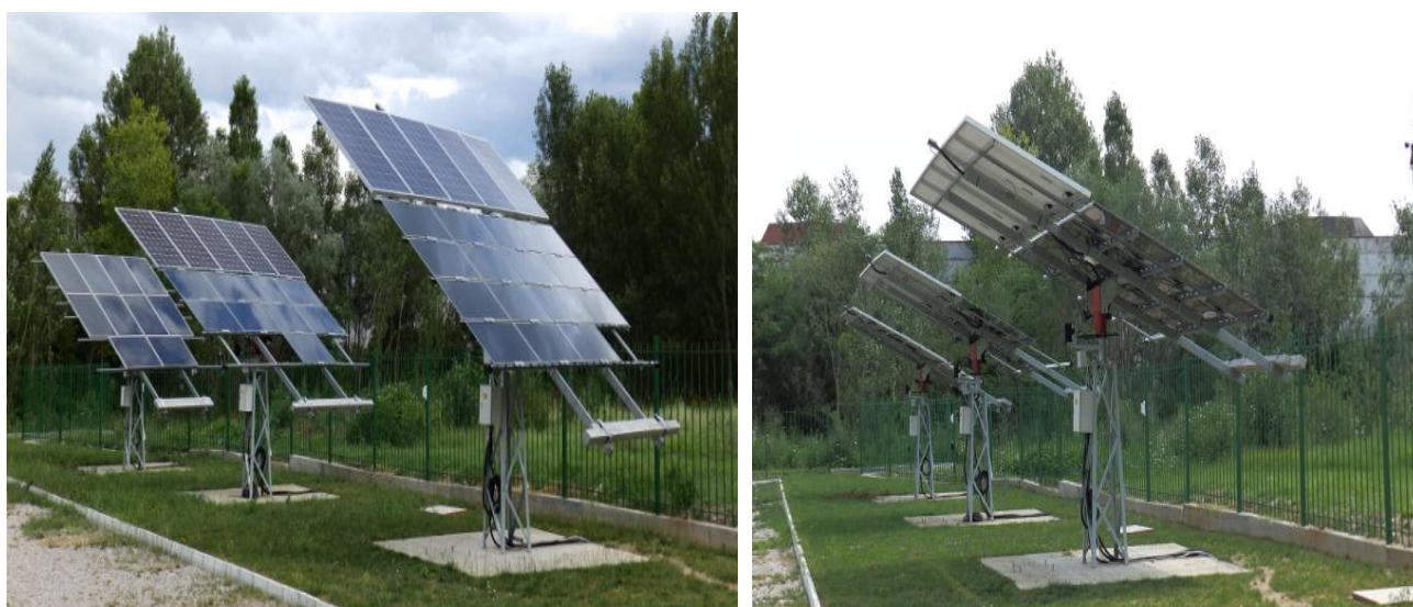
Фиг.8. Окончателен вид на слънцеследящите системи с монтирани ФВ модули.
